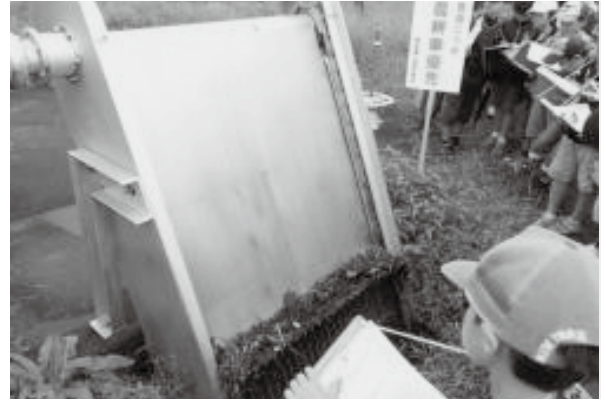
川のゴミを取り除く「除塵機」がありました。
